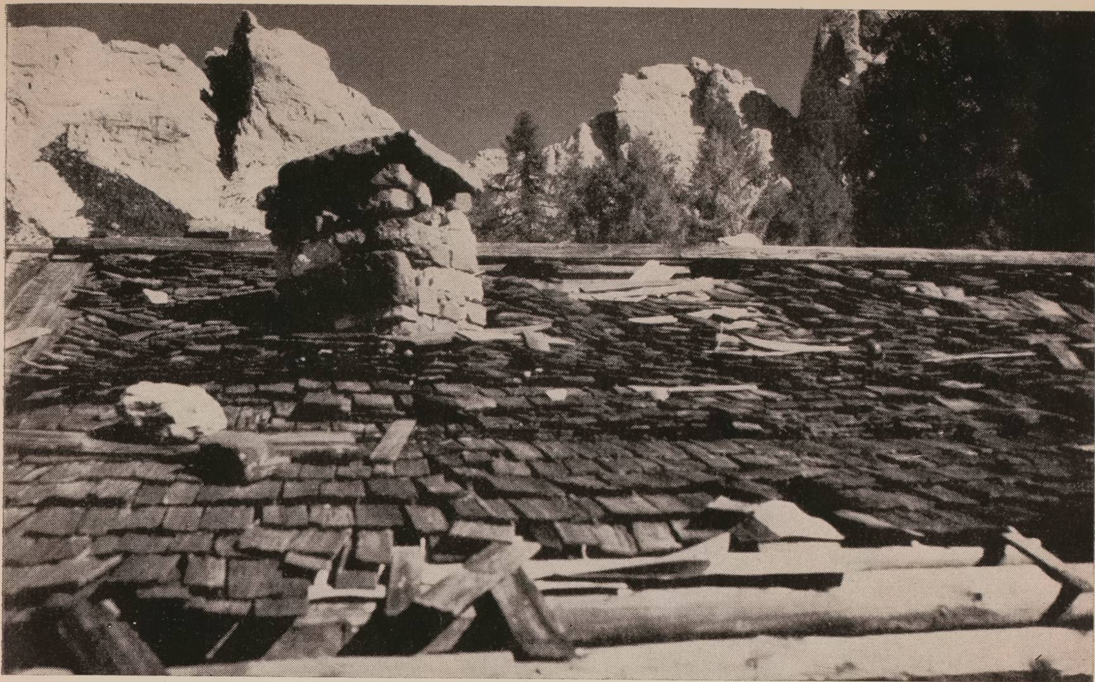
Il tetto di Cas. La Rova (o Roa), verso Cima delle Forzelette e Cima di Forcella Stretta che delimitano il varco di Forc. Larga.
