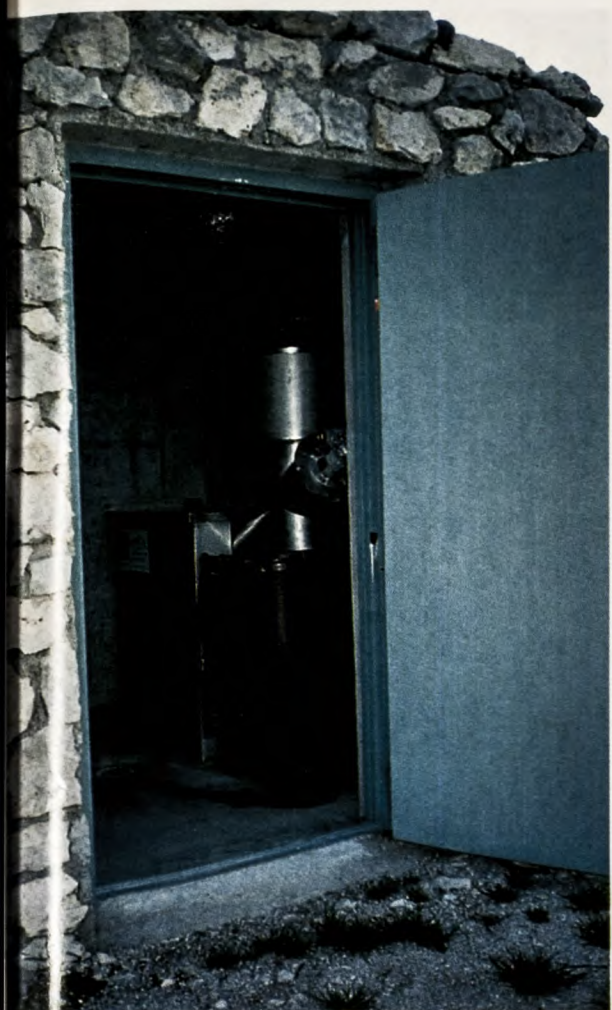
A fronte: Vasca disoleatrice dei reflui della cucina. Sopra: Impianti di grigliatura dei liquami provenienti dai bagni.
